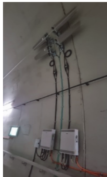
Slika 3. RRU-ovi i pripadajuće antene u tunelu
