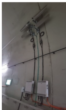
Slika 3. RRU-ovi i pripadajuće antene u tunelu
