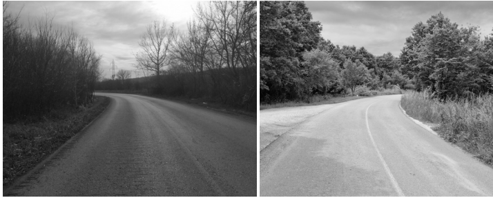
Slika 11: Nedostatak signalizacije za najavljivanje i obeležavanje krivina
